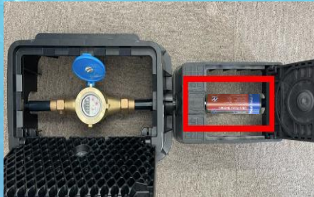
戸建住宅 設置例
